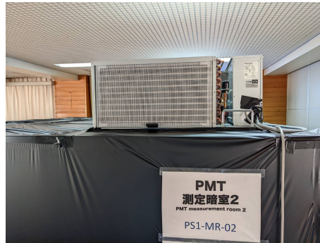
(b) 冷却器（暗室上部に設置）
