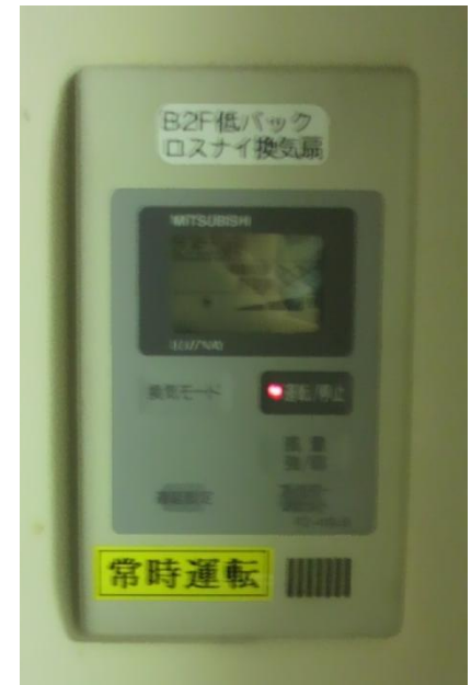
地下2階部屋の換気扇電源
